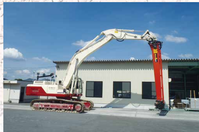
攪拌機装着全景
